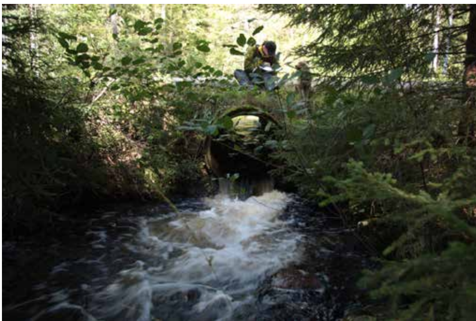
Figur 62. Hinder 9 är en felaktigt placerad vägtrumma. Hindret är partiellt för öring.
