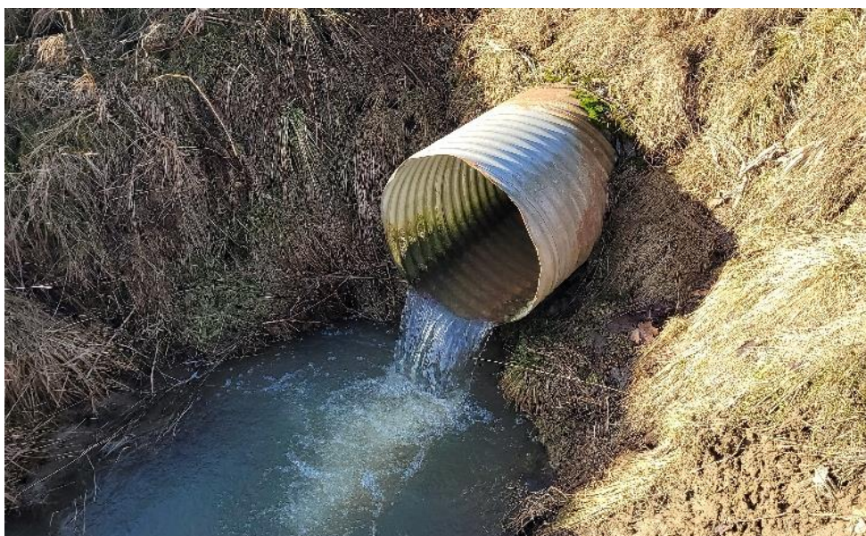
Figur 6 Felplacerad trumma i potentiellt öringförande vatten från älven.
