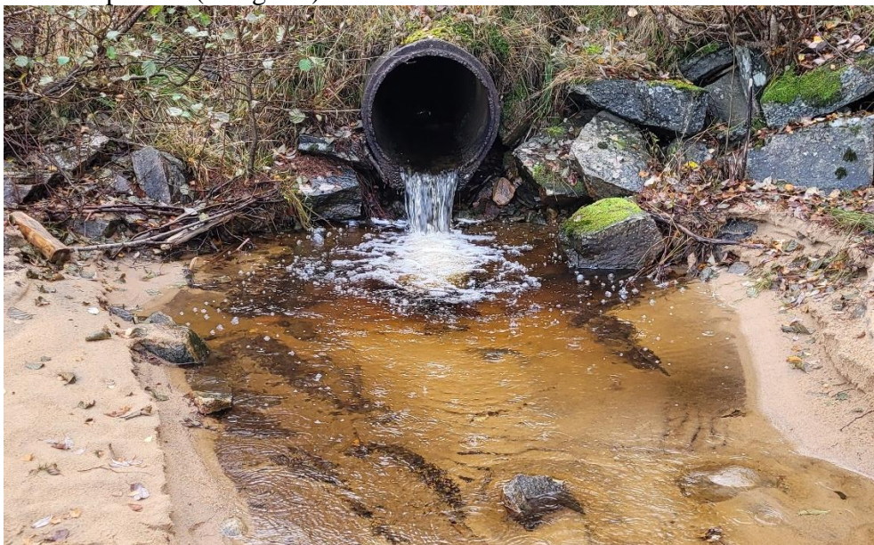
Figur 5 Ökad bottenerosion vid vägtrummas utlopp (fri ände) på grund av högt och koncentrerat vattenflöde.
